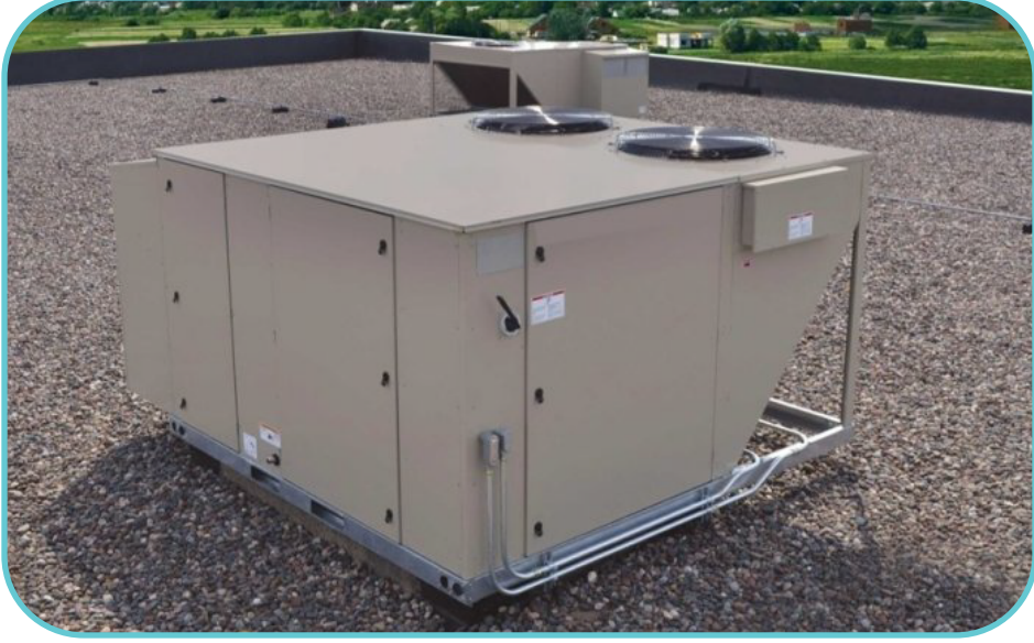
Efficient Rooftop Units (ERTUs)
